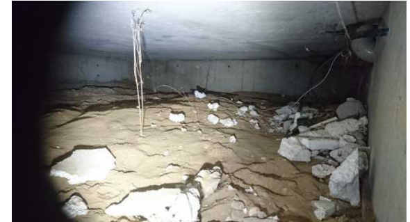
Vervuiling in de kruipruimte
